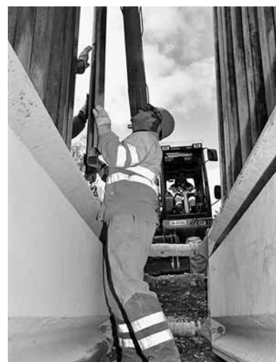
Figura 7: non si può sostare negli spazi non protetti.
